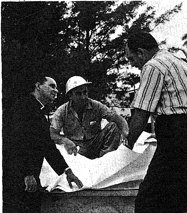
EN LA CONSTRUCCION de la capilla provisional para el monumento a la Virgen de la Caridad, el PADRE LUIS PEREZ organizador del acto de mañana, revisa los planos que le muestra el contratista ARMANDO ALEJANDRE, en presencia del capataz de la obra, HIPOLITO MOREJON.
